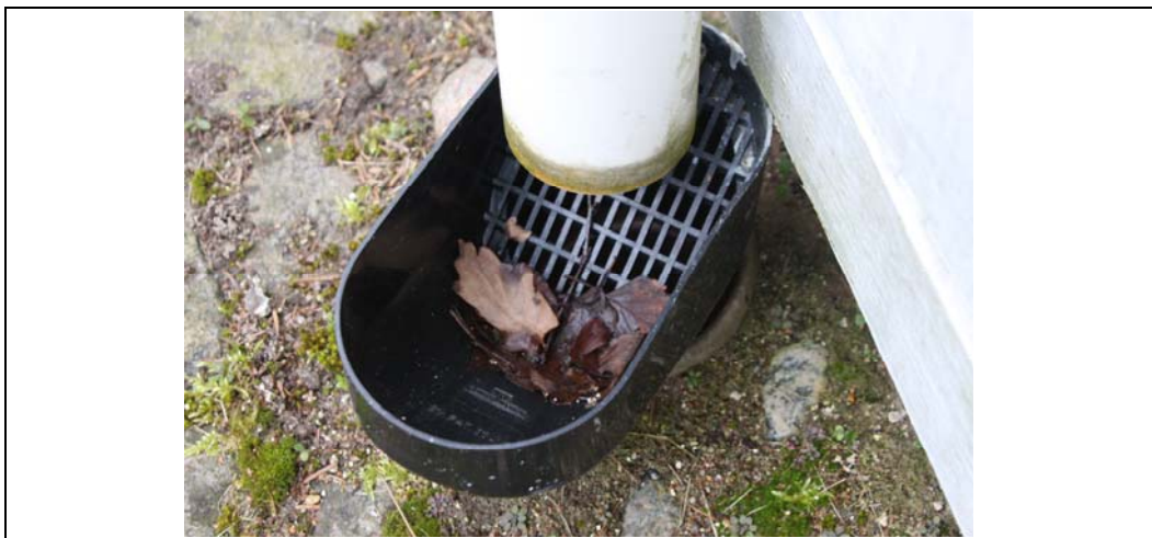
Figur 3.1 Grovfilter på tagedløb
