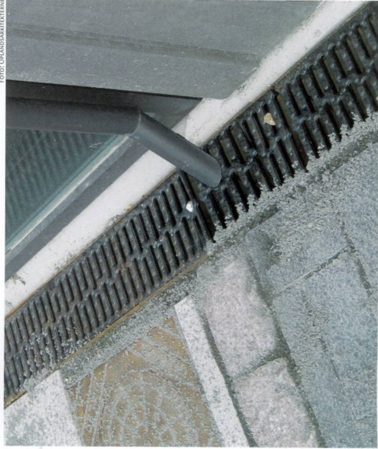
Vand fra tagnedløb løber gennem riste ned i liniedrænen, hvorfra vandet ledes via liniedrænenes små grøfter og lavninger til den centrale sø, der ses på billedet på foregående side.
