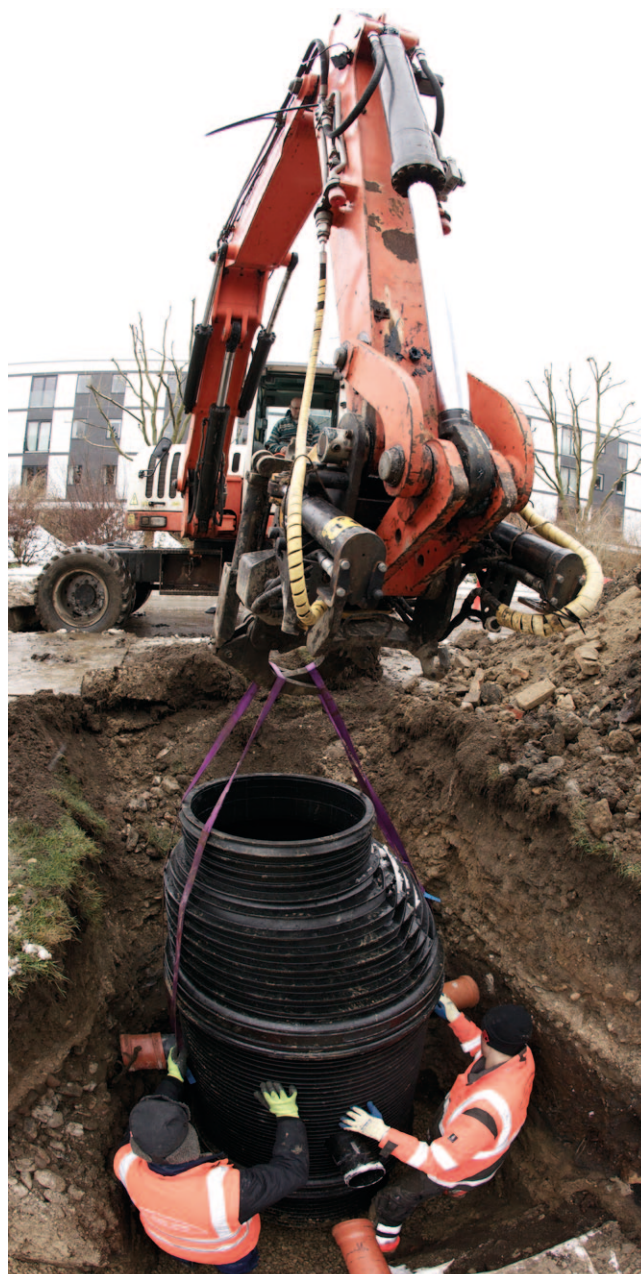
Vandet fra p-pladsen renses i indløbsbrønden, som har indbygget Enregis CRC rensfilter
